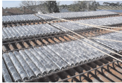
Fig. 3.6: Aquecimento solar com garrafas PET. Fonte: http://g1.globo.com/Noticias/Brasil/foto/O,,15137542-EX,00.jpg
